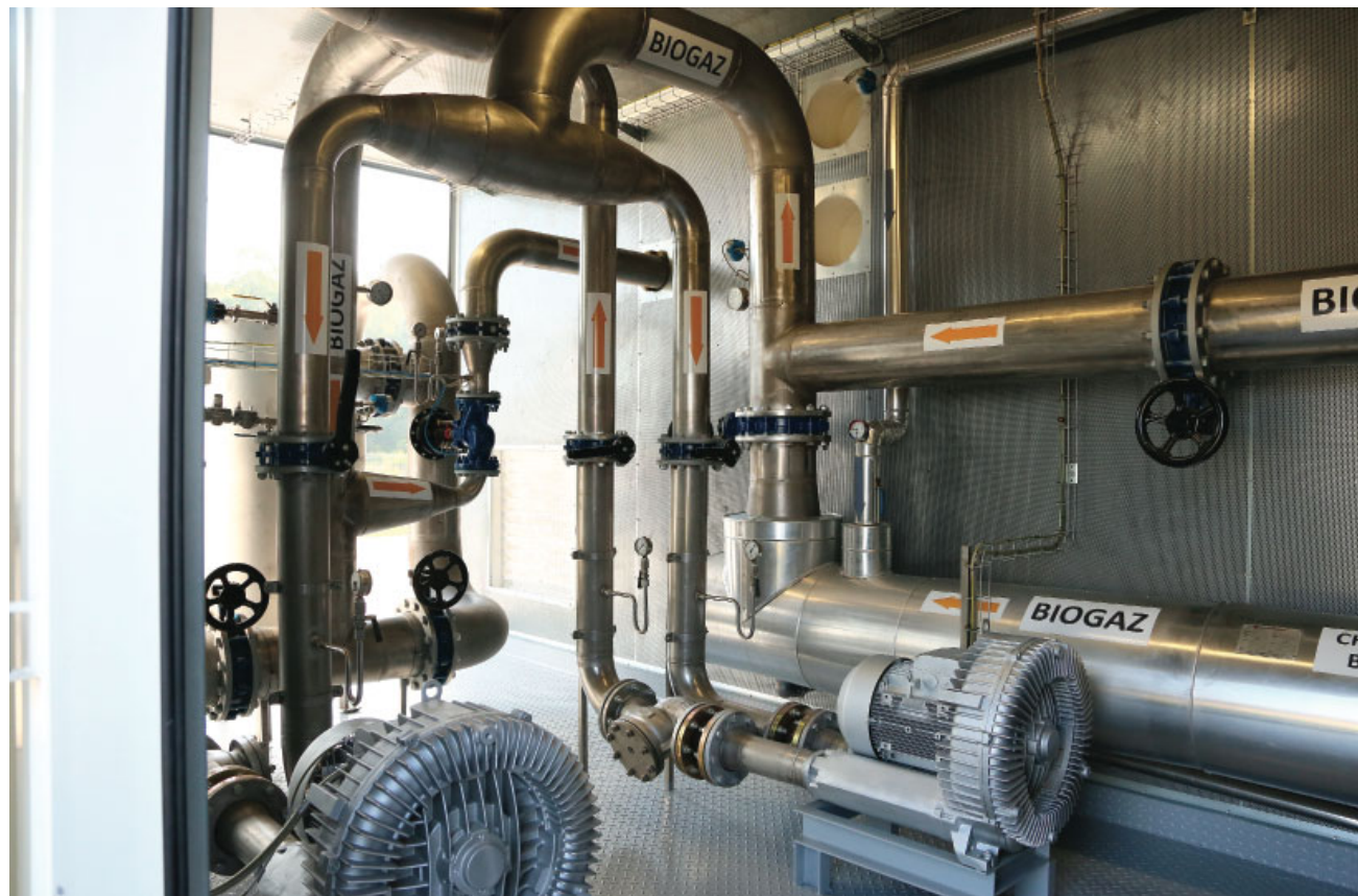
– Fragment niezwykle nowoczesnego zakładu wykorzystującego odpady biodegradowalne
