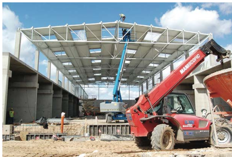
Zdjęcie z budowy obiektów ZUOK, będących miejscem wytwarzania paliwa alternatywnego na potrzeby produkcji energii dla mieszkańców Olsztyna.
