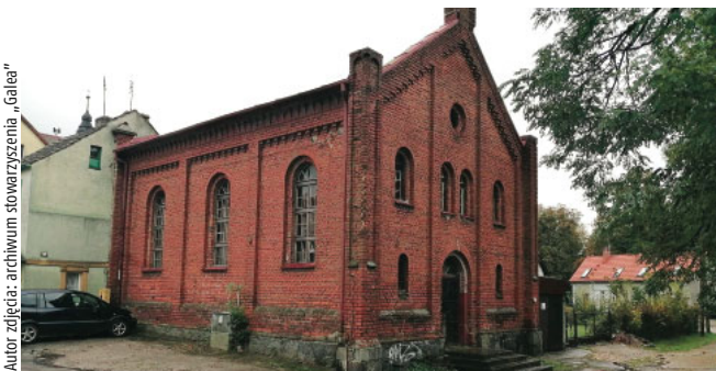
Budynek, w którym niegdyś mieściła się synagoga wymaga wielu prac naprawczych, zwłaszcza w środku
