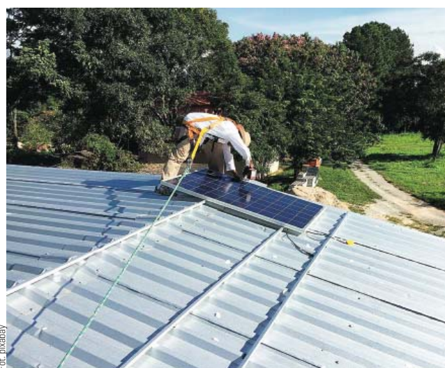
Instalacja fotowoltaiczna to prywatna elektrownia słoneczna
