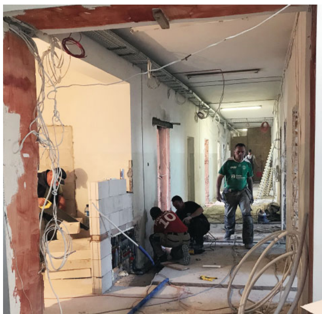
Część budynku wymaga jeszcze przebudowy
