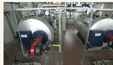
Kotłownia SP ZOZ w Działdowie po modernizacji
