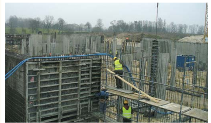
Zakończono stan surowy budynku kotłowni. Aktualnie prowadzone są roboty ziemne pod wioskę wakacyjną.
